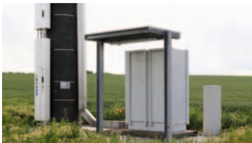
Basisstation (Foto: PG Digitalfunk UNTERFRANKEN)
